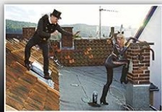
CHIMNEY SWEEP Partner: Martin Wassermann / www.feuer-wassermann.de Location: Privatgebäude, Hameln Model: Randy / Schornsteinfeger: Martin
